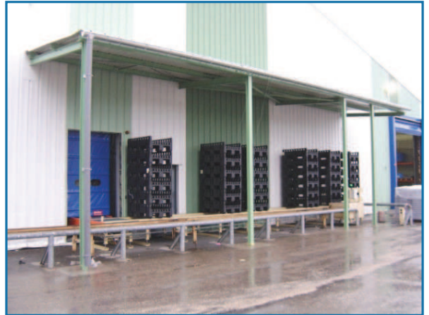
Convoyeur d'arrivée des piles
